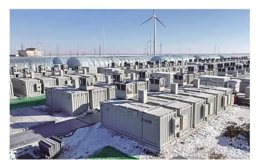
百兆瓦级全钒液流电池共享储能电站。大连化物所供图
