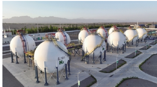
中国石化新疆库车绿氢示范项目储氢球罐。
